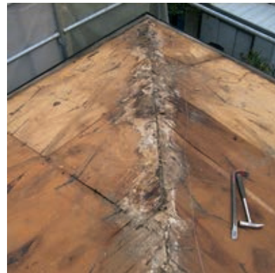
③野地板の腐食
