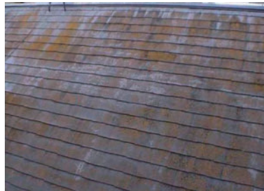
②表面汚れ・塗装の剥離
